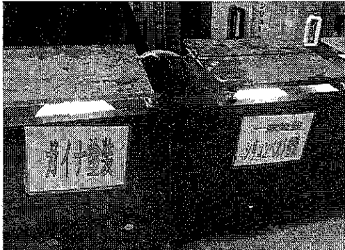
自社モデルルーム内には遮熱塗料の効果が実証、体感できるコーナーがある。光熱費が割安になった実例も紹介する
